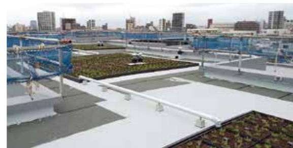
植栽帯外を横断する部分には、塩ビ管に凍結防止の保温措置を施した渡り配管を用います。
