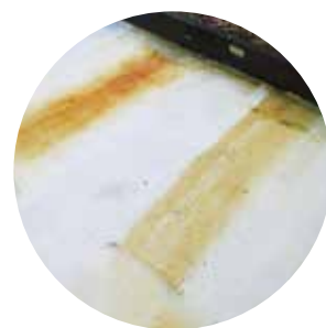
雨水等に起因する防水層表面汚れ
