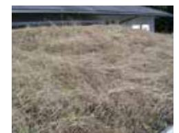
雑草が繁茂し植栽が被圧され衰退
